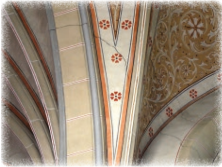
Rissbildungen im Gewölbe des linken Chorraumes aufgrund statischer Mängel des hinteren Turmes.
